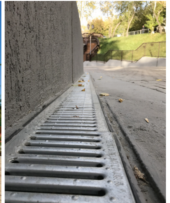
▲ Ул. Масловский взвоз, г. Тюмень Линейный водоотвод. Серия Basic (Класс нагрузки A15)
